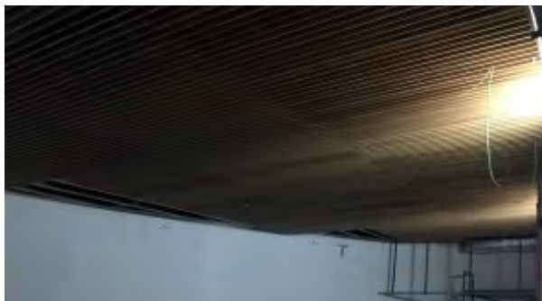
Proceso de montaje del techo acústico del auditorio, dónde tablero de fibras ignífugo con lamas acabadas de bambú se ha colocado a modo de peine.
